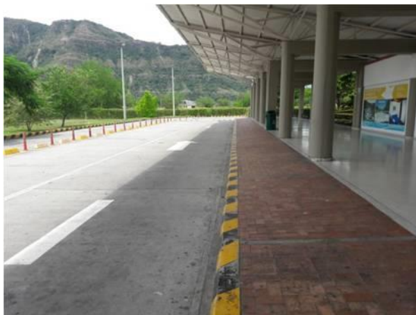
Fotografía 257 Plataforma de Descenso
