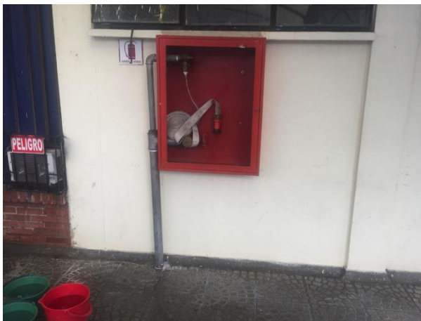
Fotografía 108 Red Contra incendios
