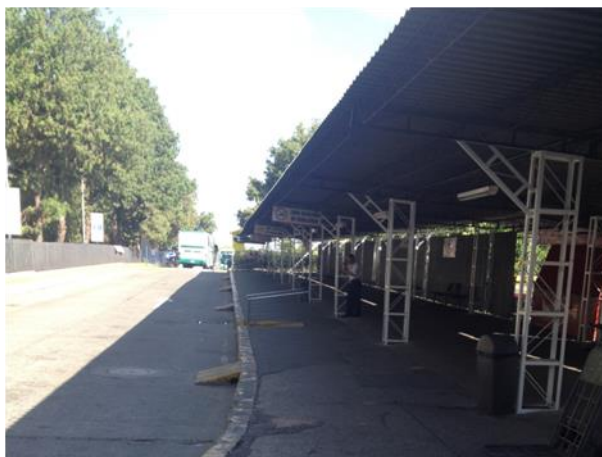
Fotografía 178 Plataforma de Descenso
